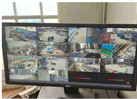
监控设备运行
