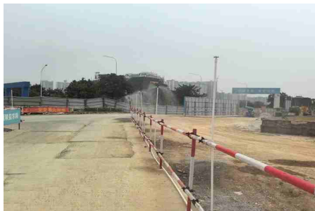
场内主干道喷淋系统
